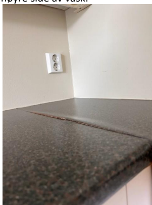
Fuktskade i vinkel skjøt til benkeplate.
