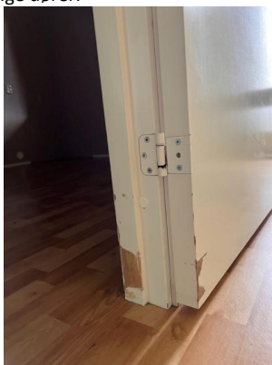
Slitasje på innvendige dører.
