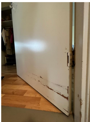
Slitasje på innvendige dører.
