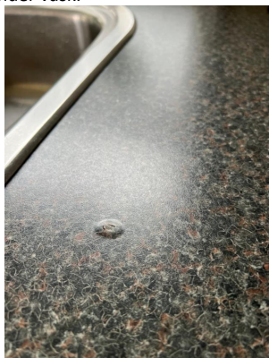
Skade i laminat på høyre side av vask.
