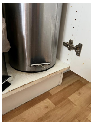
Fuktskade i skap under vask.
